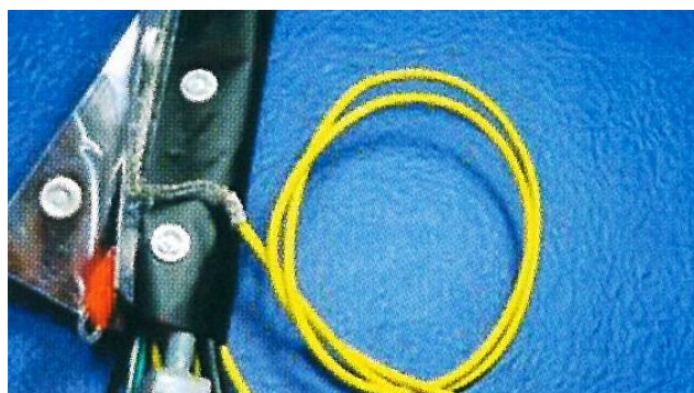
写真 3 接地線の処置状態
